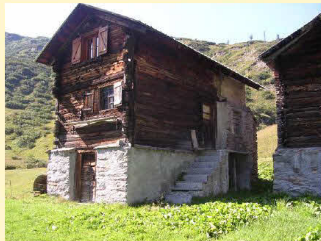
Esempio non corretto, il tetto in lamiera ed il serramento centrale stravolgono la tipologia tradizionale
