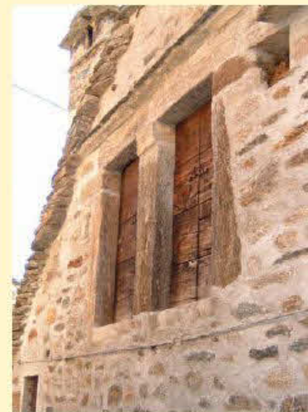
Intervento sbagliato, seppur la realizzazione della miscela di intonaco è corretta risulta troppo invasiva rispetto alla muratura tradizionale
