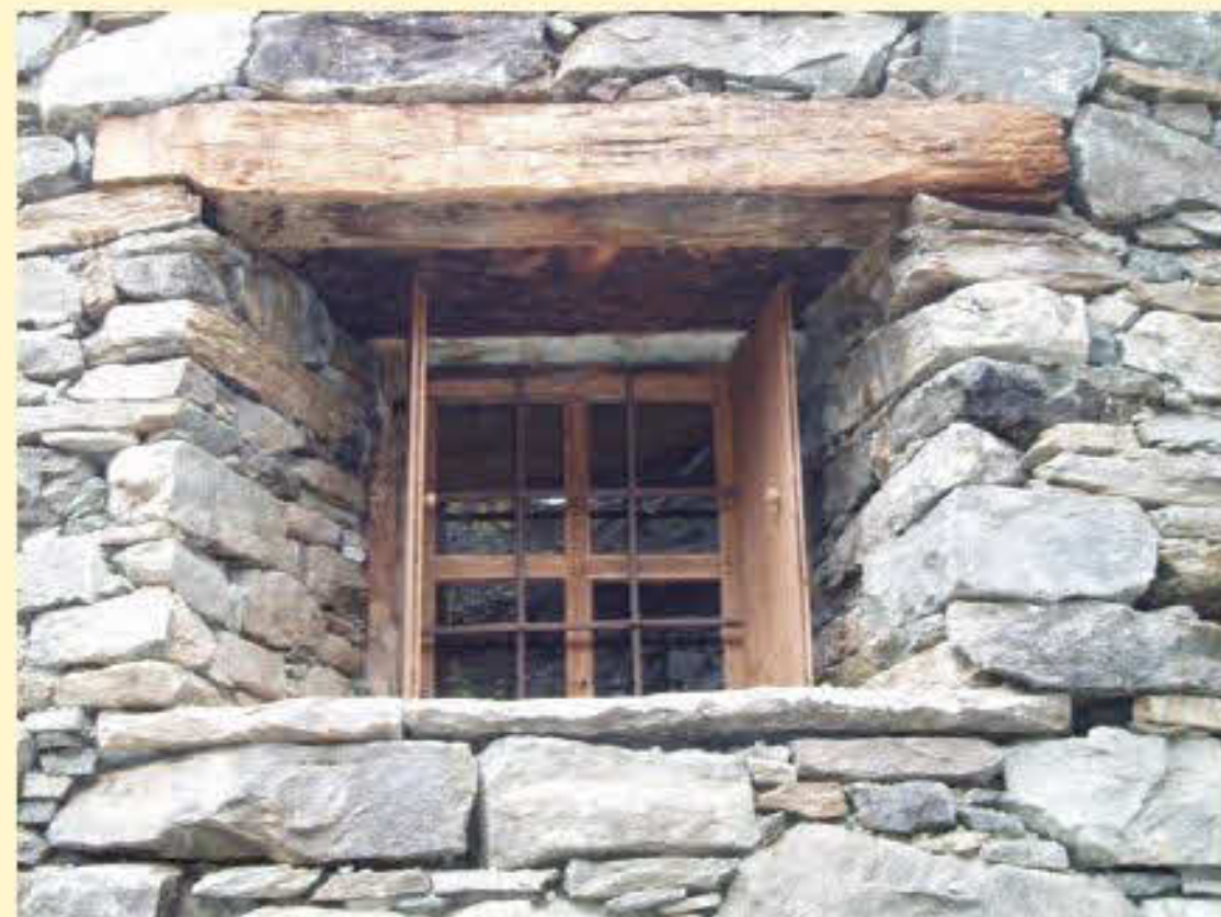
Nel restauro del serramento si è mantenuto l'architrave in legno e l'inferriata in ferro
