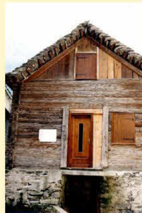
Intervento sbagliato, l'edificio ha una buona struttura ed una bella copertura ma i serramenti lo stravolgono completamente
