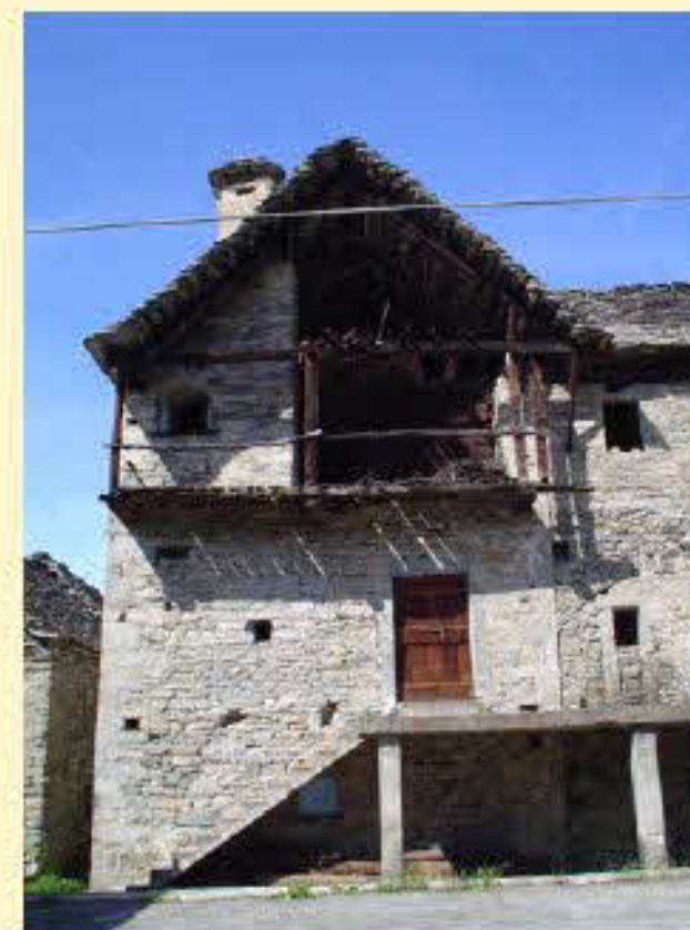
Intervento errato, si è sostituita la scala in legno con un elemento in cemento armato
