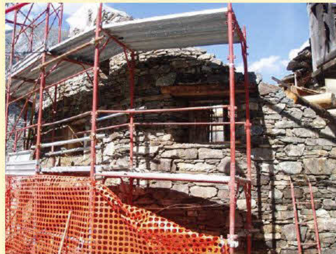
Intervento di consolidamento muratura ove non è visibile la ristilatura dei giunti
