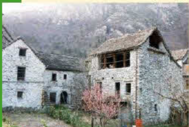
Esempio di edificio con il lastric, ultimo piano aperto con soletta in legno
