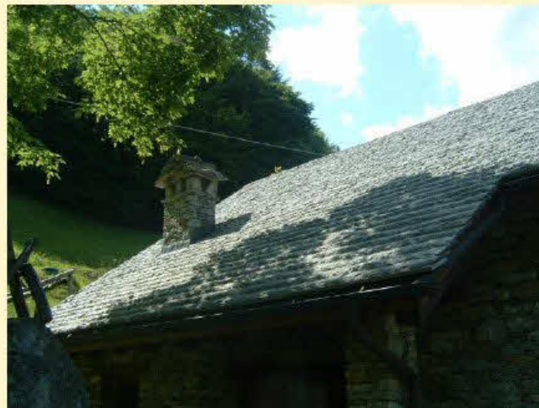
Intervento sbagliato in quanto lo spessore delle piode è nettamente inferiore a quello tradizionale
