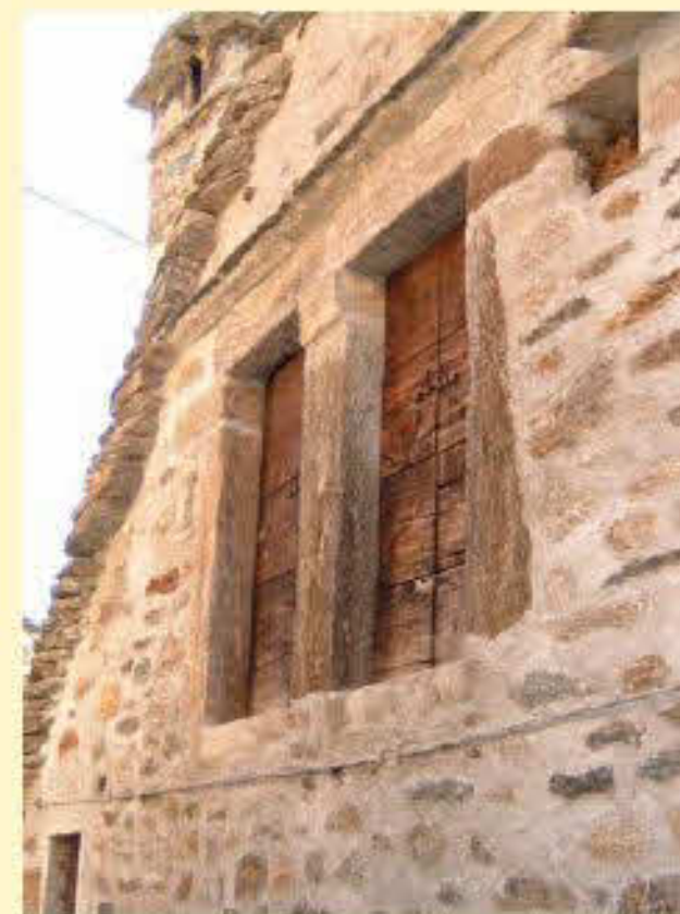
Intervento sbagliato, seppur la realizzazione della miscela di intonaco è corretta risulta troppo invasiva rispetto alla muratura tradizionale
