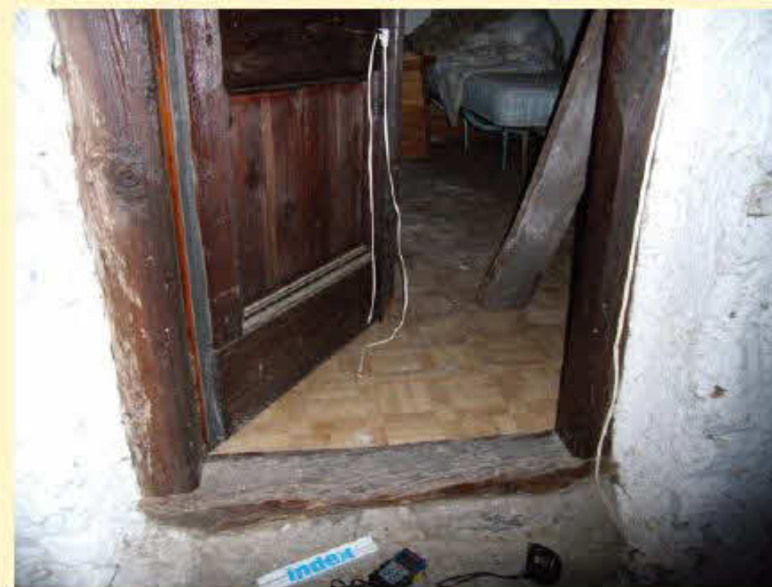
Intervento sbagliato, sulla soletta in legno è stato posato del linoleum
