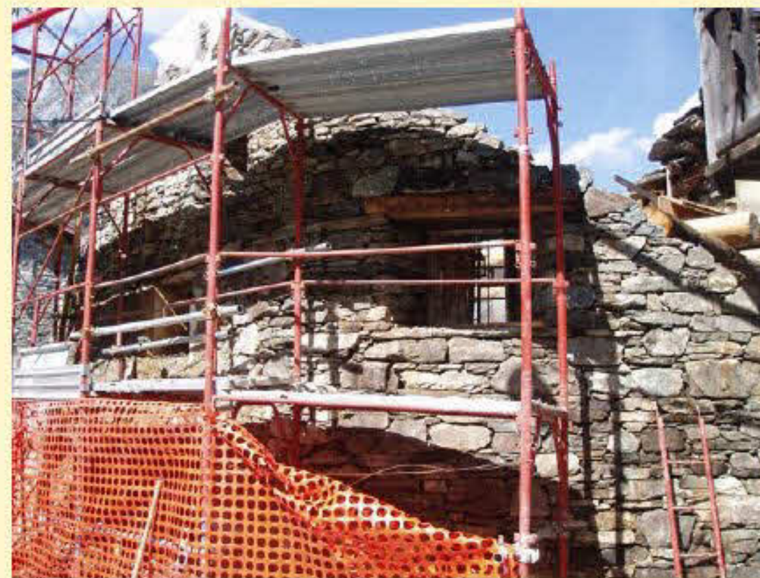
Intervento di consolidamento muratura ove non è visibile la ristilatura dei giunti
