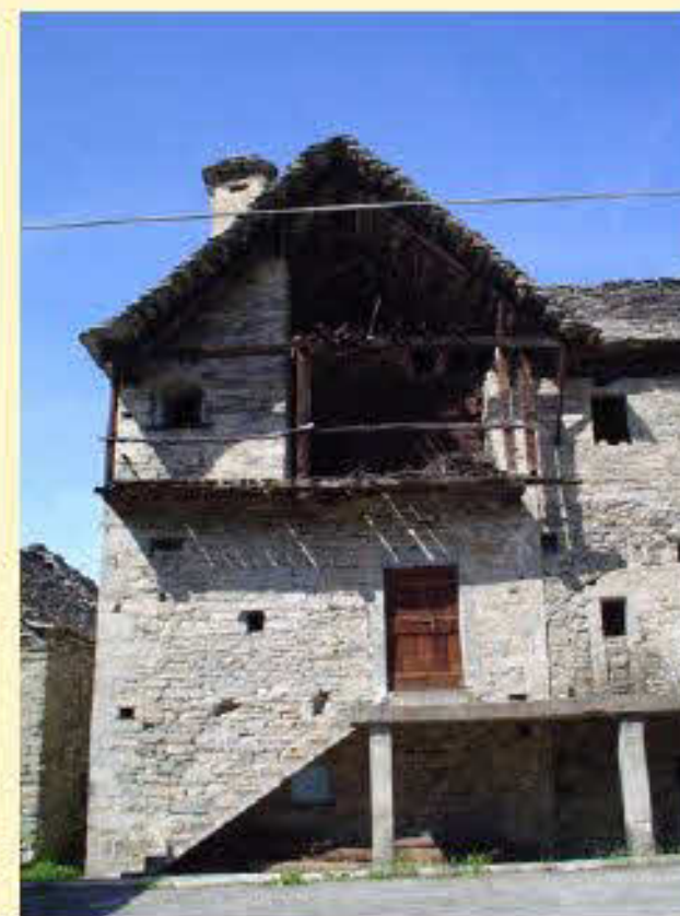
Intervento errato, si è sostituita la scala in legno con un elemento in cemento armato
